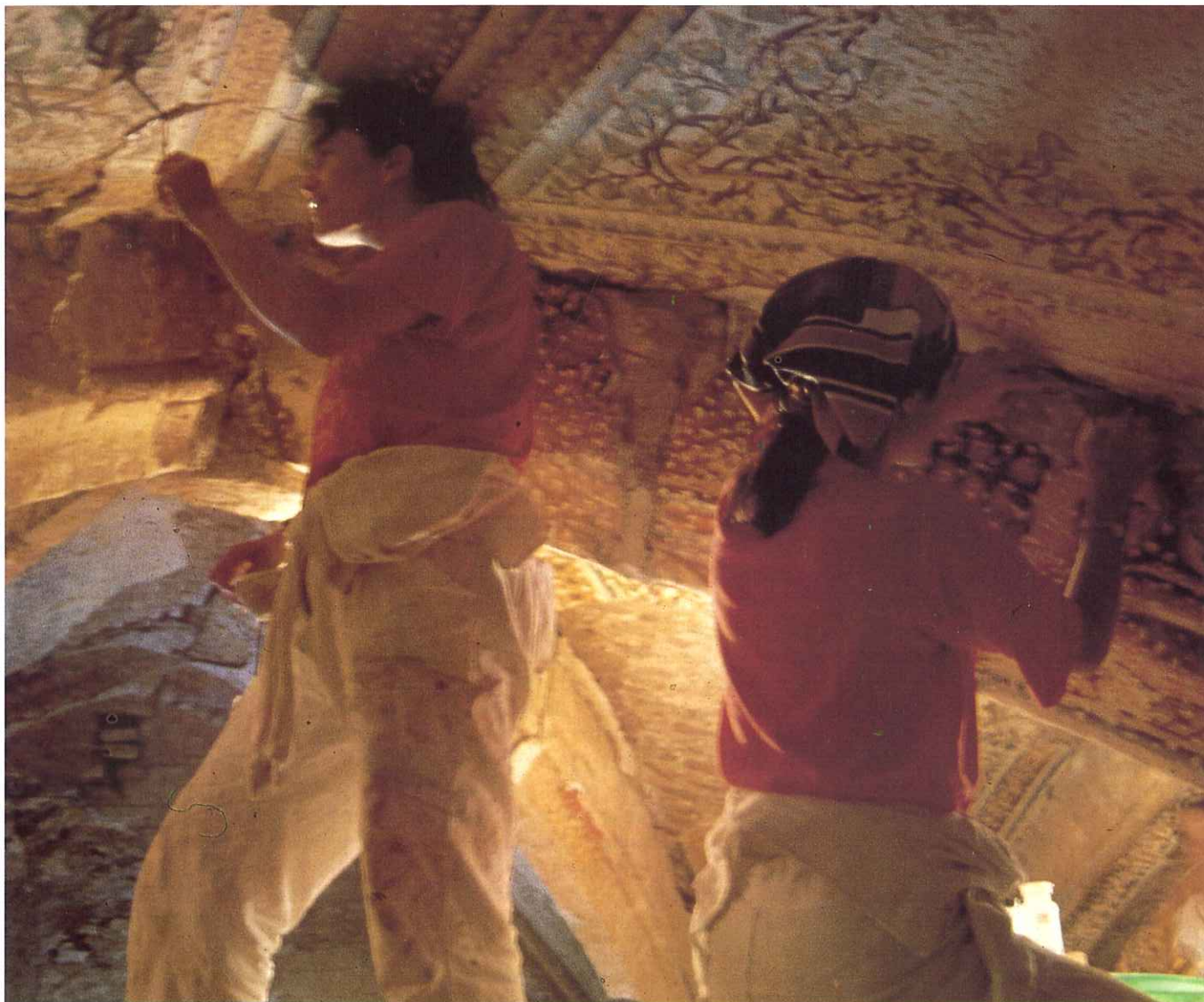
Bóveda del XVII de la S. Capítular de S. Isidoro del Campo. Antes de cinchar es imprescindible consolidar la película pictórica. Hay que consolidar antes de apear las pinturas.
