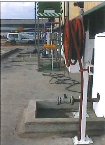
Protecciones zona química
