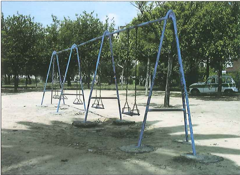
Instalación y mantenimiento inadecuados. Cimentación de columpios aflorando en superficie. NORMA UNE-EN 1176. PARTE 7
