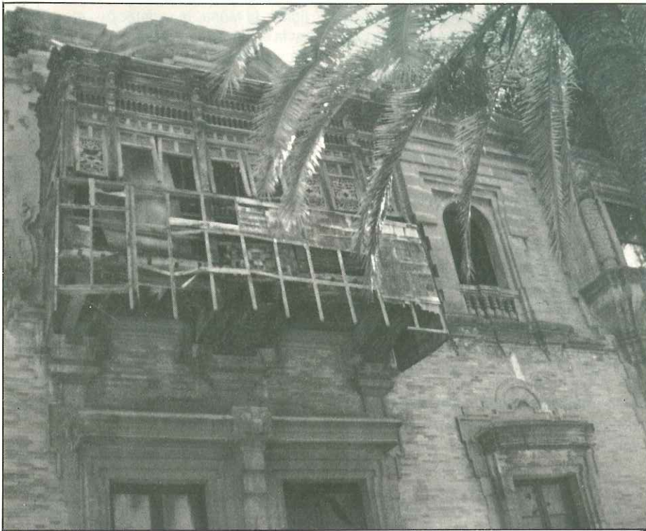
Estado de deterioro en que se encontraban los cierres de madera de las balconadas
