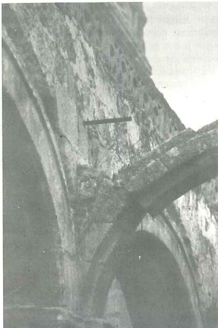
Arco transversal con dovelas desplazadas y tirante cortado
