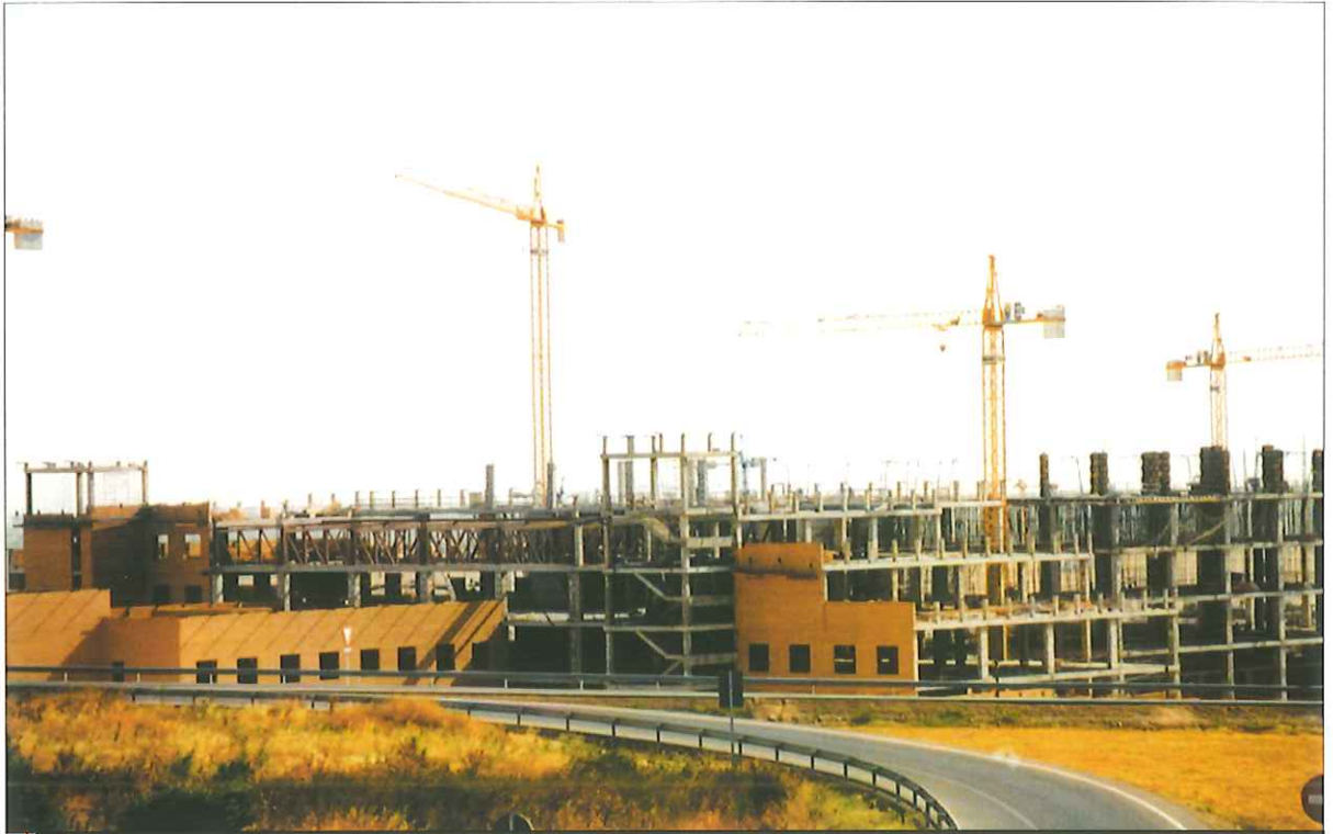
Construcción del Hospital Comarcal de la Orden Hospitalaria de San Juan de Dios
