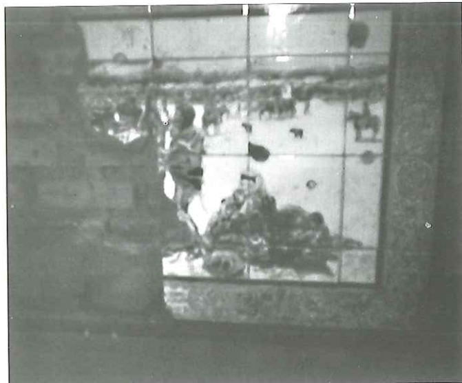
Estado actual del cuadro cerámico de la Glorieta de García Ramos es absolutamente deplorable.
