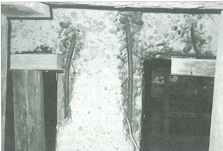
Patología de un pilar
