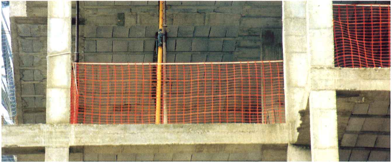
Red de peto, sustitución de malla de cuerda por malla alveolar plástica. No se considera medio de protección, es mera señalización de riesgo.
