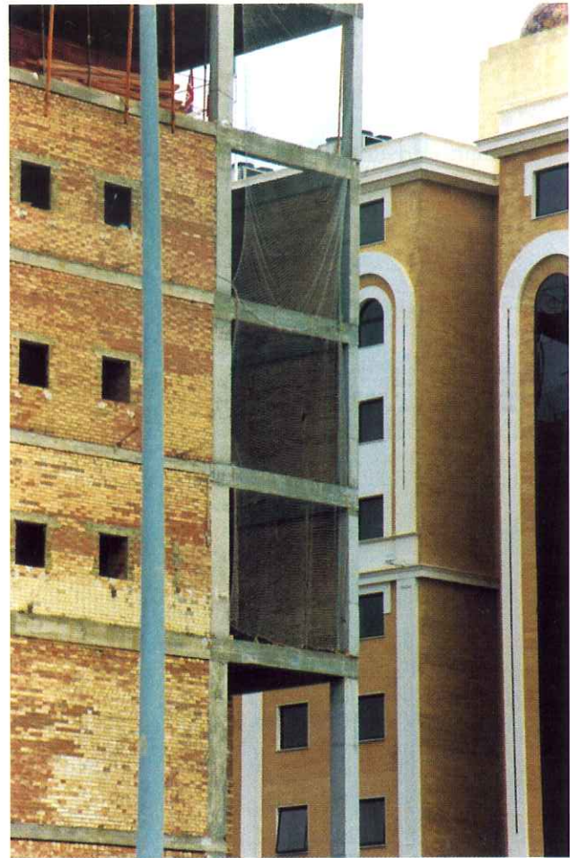
Red paramentada a fachada, con deficientes cogidas. No ofrece garantía de uso.
