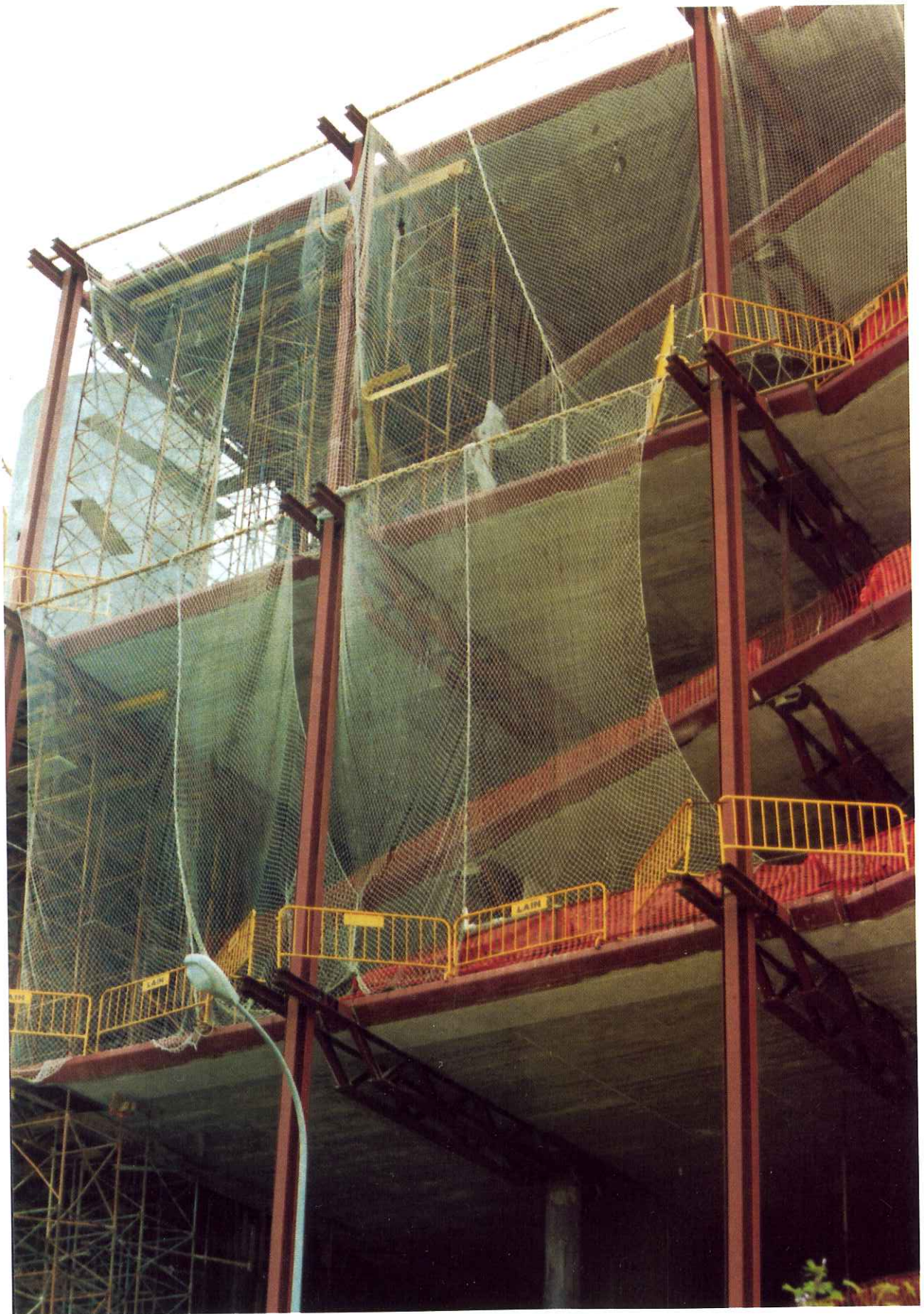
Red suspendida de barra horizontal dejando grandes espacios abiertos por los laterales. Tubos horizontales de reducida sección. Curiosa protección de bordes de estructura con barandillas portátiles. Su conjunto presenta grandes anomalías y es de dudosa efectividad.
