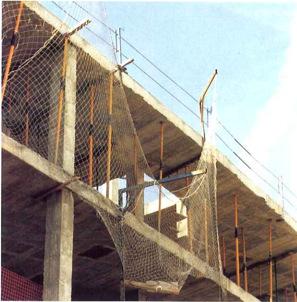
Materiales caídos sobre red y soporte corrido hacia abajo, dejando su frente sin cubrir.
