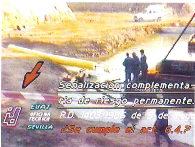
Fig. 5. Señalización complementaria de riesgo permanente. La cintas roja en bandas alternadas oblicuas sobre fondo blanco, debe hacer reflexionar sobre el cumplimiento de la norma.
