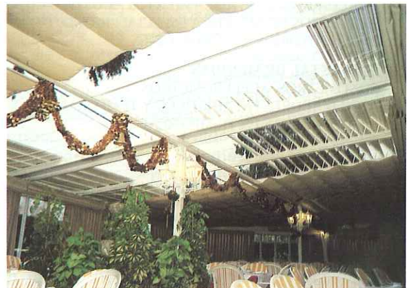
Instalación realizada en: RESTAURANTE EL BARCO (GINES-SEVILLA)
