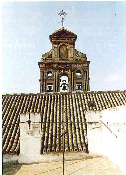
Cara por levante (interior del convento). Véase el sistema de tirantes.
