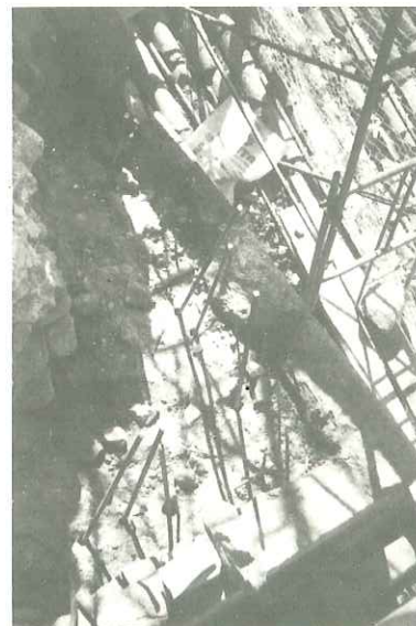
Aspecto general de cosidos en la esquina
